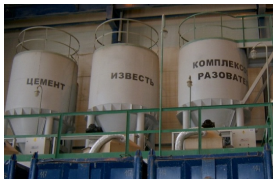
Рисунок 19. Установка стабилизации и капсулирования твердых НСО ООО «ЛУКОЙЛ-Калининградморнефть»
